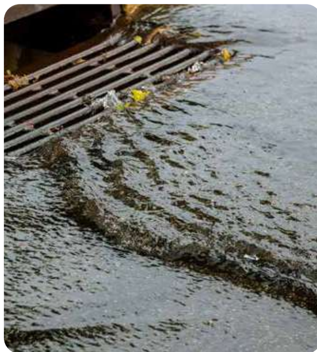
Sumidero alcantarillado pluvial. Foto: Adobe Stock-AdobeStock_283273796
